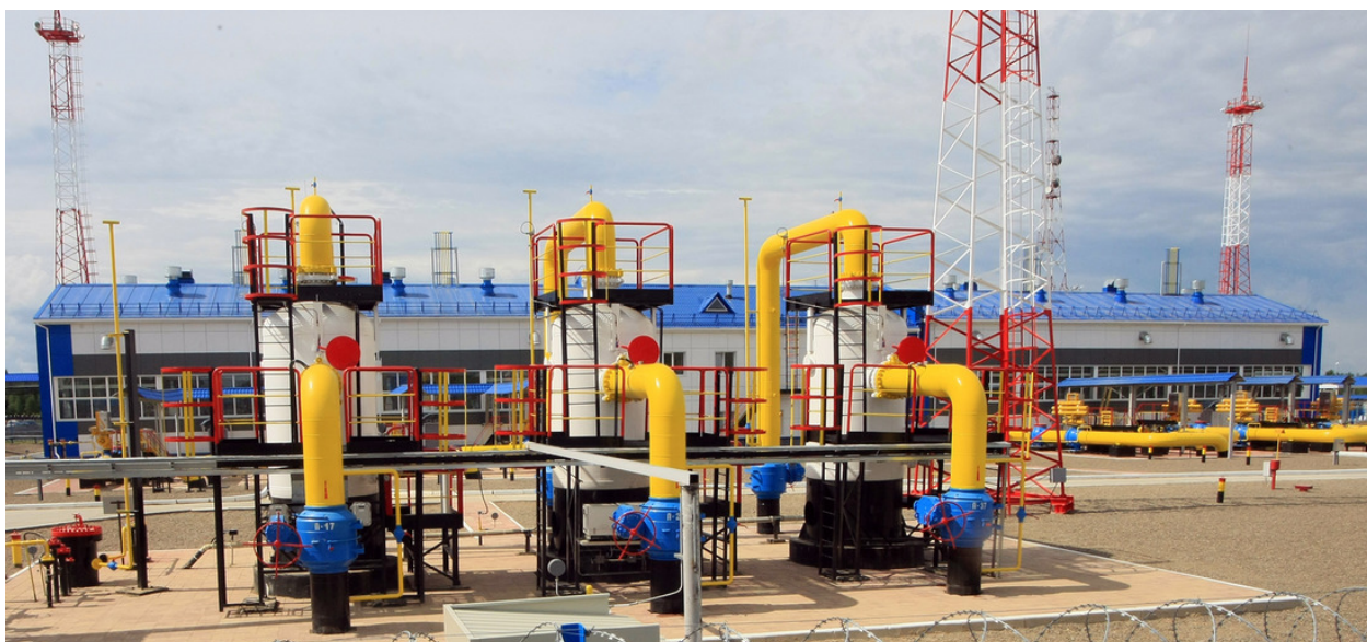
Рис. 2. Компрессорная станция «ПарABELь» Томское линейно-производственное управление магистральных газопроводов (фото ООО «Газпром трансгаз Томск»).
